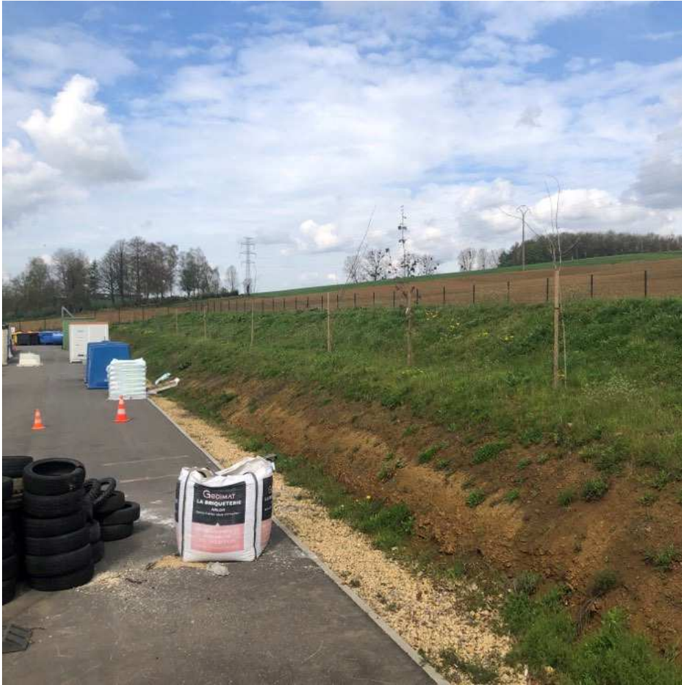
Arrière du parc à conteneurs : le chemin longera la parcelle en contre-haut
